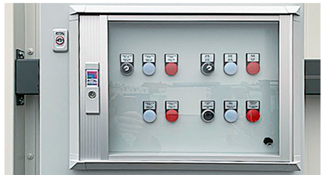
Einhausung des Bedienelements: Kontroll- und Bedienelemente sind in der Schaltschrankfront vor unbefugtem Zugriff geschützt.
