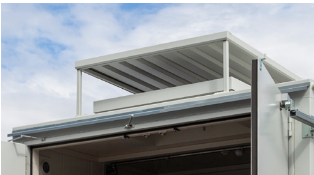
Die Druckentlastung erfolgt im Fall einer Explosion über die Dachfläche. Der Wetterschutz verhindert eine mögliche Beeinträchtigung durch Schneelasten.
